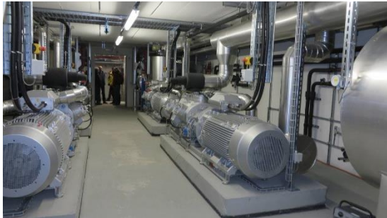
Energieverbund St. Moritz Bad versorgt mit Wärme aus dem See. © St. Moritz Energie .
